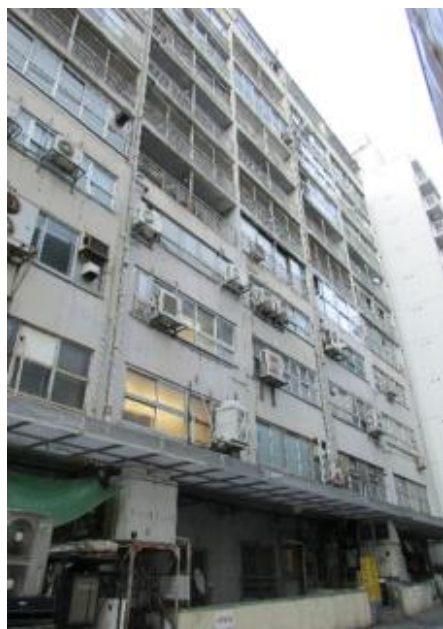
外壁に剥落対策の金網
