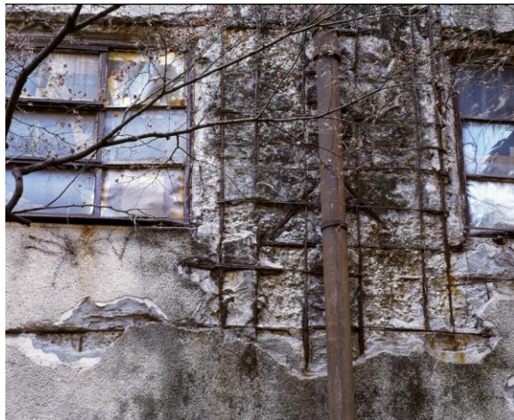
爆裂により露出した鉄筋
