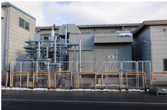
1 台で一般世帯 300 世帯分を賄えるコージェネ設備
