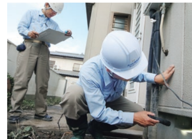
水害にあったヘーベルハウスを点検する作業員
