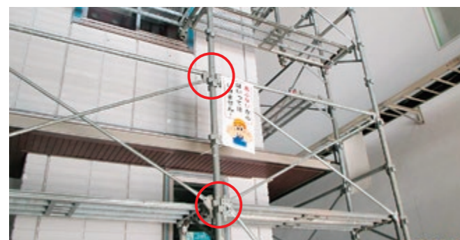
「単管足場」から「くさび緊結式足場」へ変更 コの字状に溶接加工された緊結部付支柱にくさびを打ち込んで組み立てる
