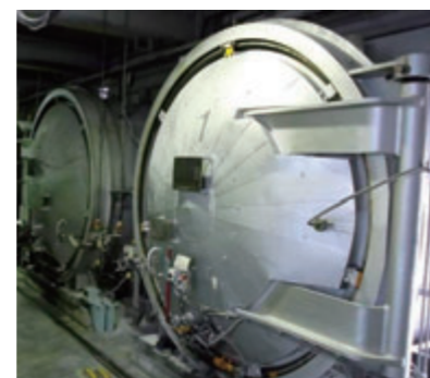
ヘーベル製造用オートクレーブ
